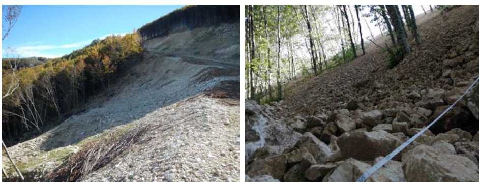
Fig. 9 – A sinistra, versante in frana con smottamenti attivati dai lavori di scavo e accumulo dei detriti, effettuati senza alcuna attenzione allo stato di rischio ambientale, peraltro ben conosciuto; a destra cumulo di detriti scaricati con noncuranza a valle delle piste che rendono difficile il recupero e la sopravvivenza del bosco di faggio scampato all’eradicazione diretta.
